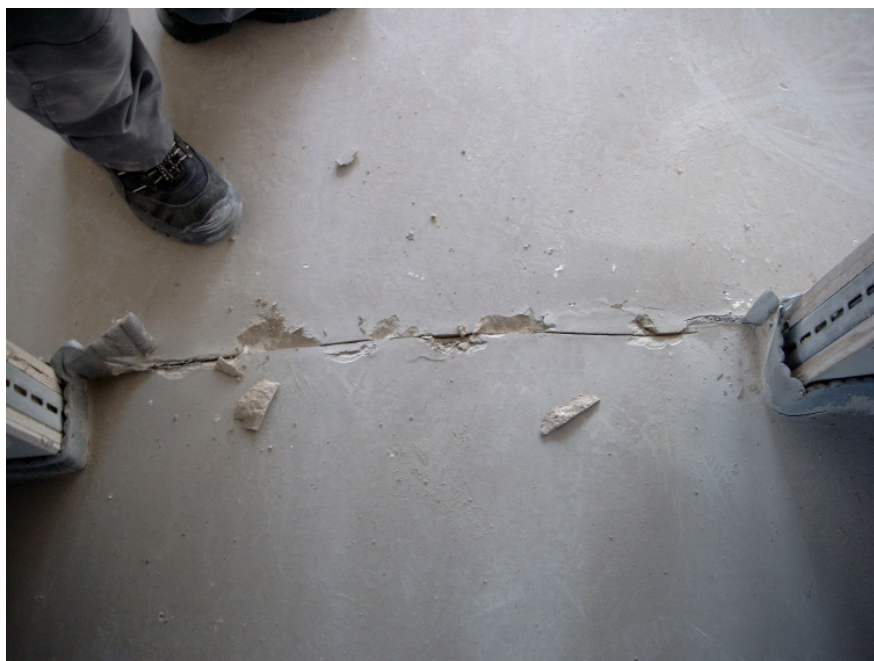
Bild 2: Fugen müssen geradlinig in der Flucht angeordnet werden. Die hier abgebildete Fuge wird sich wohl kaum in einen keramischen Belag übernehmen lassen.
