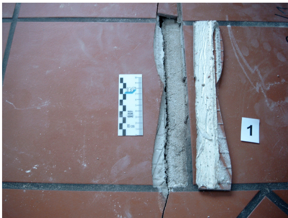
Bild 3: Der Fugenverlauf hätte vorher abgestimmt werden müssen, dann wäre dieser Riss gar nicht erst aufgetreten. Die Entkopplung über ein Klebeband führte in diesem Fall nicht zum Erfolg.
