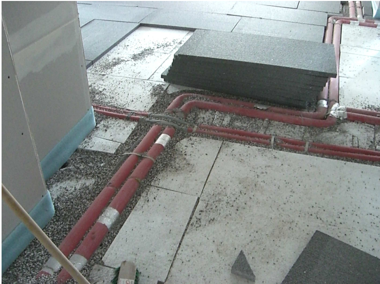
Bild 1: Heizrohre und Kabelleerrohre auf einer Rohdecke - Trittschalldämmung kann nicht mehr normgemäß verlegt werden.
