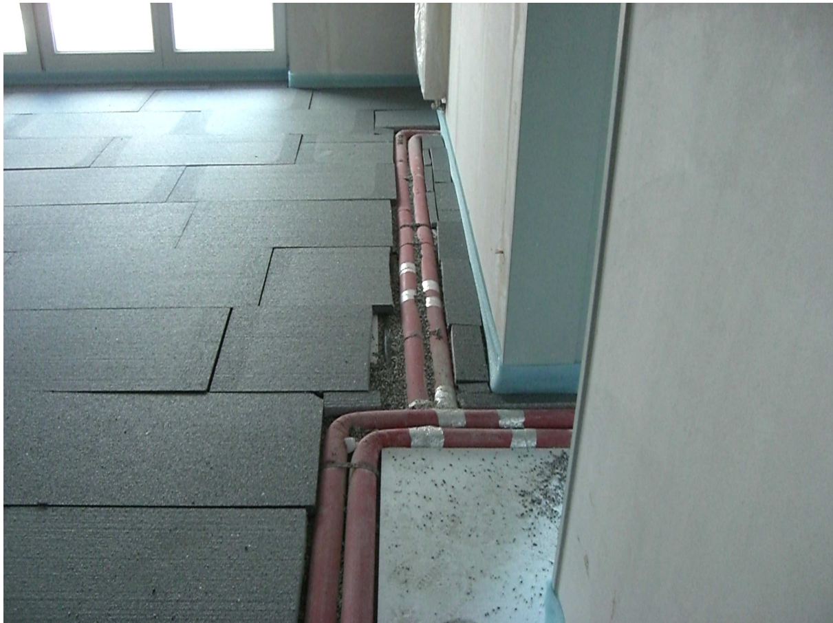
Bild 2: Heizrohre und Kabelleerrohre auf einer Rohdecke - Trittschalldämmung kann nicht mehr normgemäß verlegt werden.
