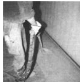
Bild 37 Die Randstreifen müssen so breit gewählt werden, dass sie über die Oberkante des Estrichs hinausragen. Das Abschneiden darf erst nach der Belagsverlegung erfolgen
