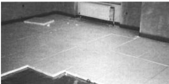
Bild 34 Die Verlegung der Trittschalldämmplatten auf festem Leichtmörtel-Untergrund ist einfacher als auf einem Ausgleich aus Dämmplatten
