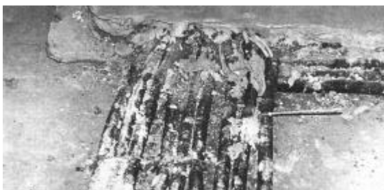
Bild 15 Eine derartige Ansammlung von dicken Rohren, die durch die Dämmschicht nicht völlig ausgeglichen werden können, führt nicht selten zu Rissen im Estrich
