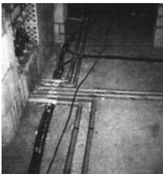
Bild 1 Rohre und Kabel liegen kreuz und quer auf der Rohdecke
