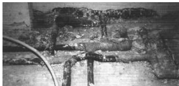
Bild 3 Rohre in mehreren Lagen übereinander
