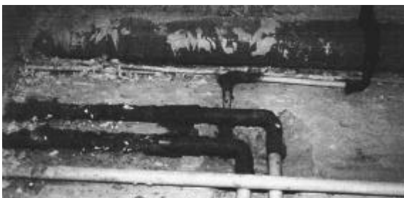
Bild 2 Abflussrohre werden nicht eingekleidet
