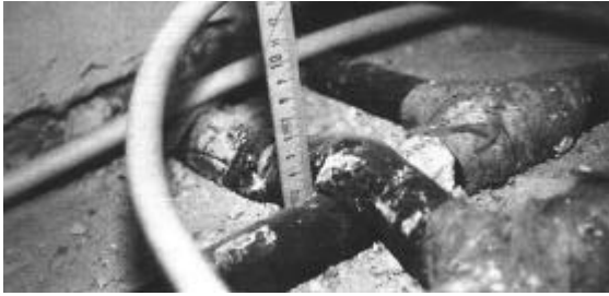
Bild 4 Sechs Zentimeter Rohrdicke bei vier Zentimeter Dämmschichtdicke sind nicht selten
