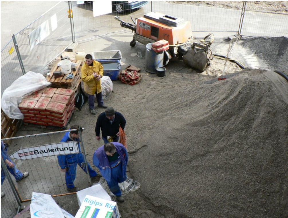
Güteschutz Estrich - Überprüfung des Mischplatzes und des Mischvorgangs bei der Estrichherstellung im Zuge der Fremdüberwachung
