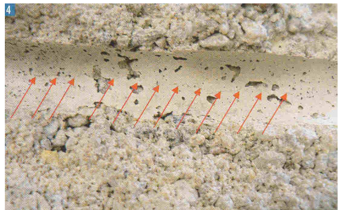
Bild 4: Zu sehen ist ein Riss oberhalb eines Heizrohrs. Entstanden ist er aufgrund zu geringer Rohrüberdeckung des Estrichs.
