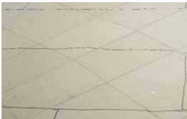
Typisches Rissbild eines Belags auf einem Trockenhohlboden
