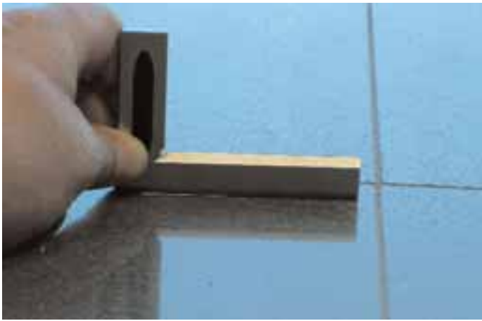
Die Konstruktion hat sich zwischen den Stützen verformt. Die Ebenheit ist nicht mehr gegeben. Der Naturwerkstein ist gebrochen
