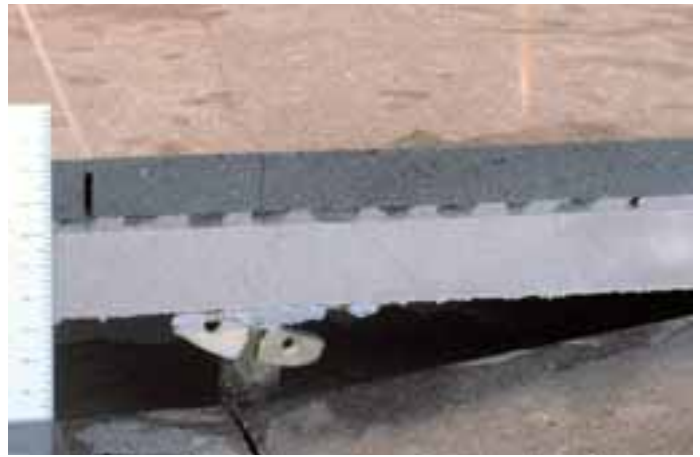
Schnitt durch die Bodenkonstruktion: Riss genau oberhalb der Stütze
