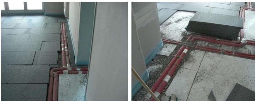
Bilder: fehlende Konstruktionshöhe für eine fachgerechte Dämmstoffverlegung
